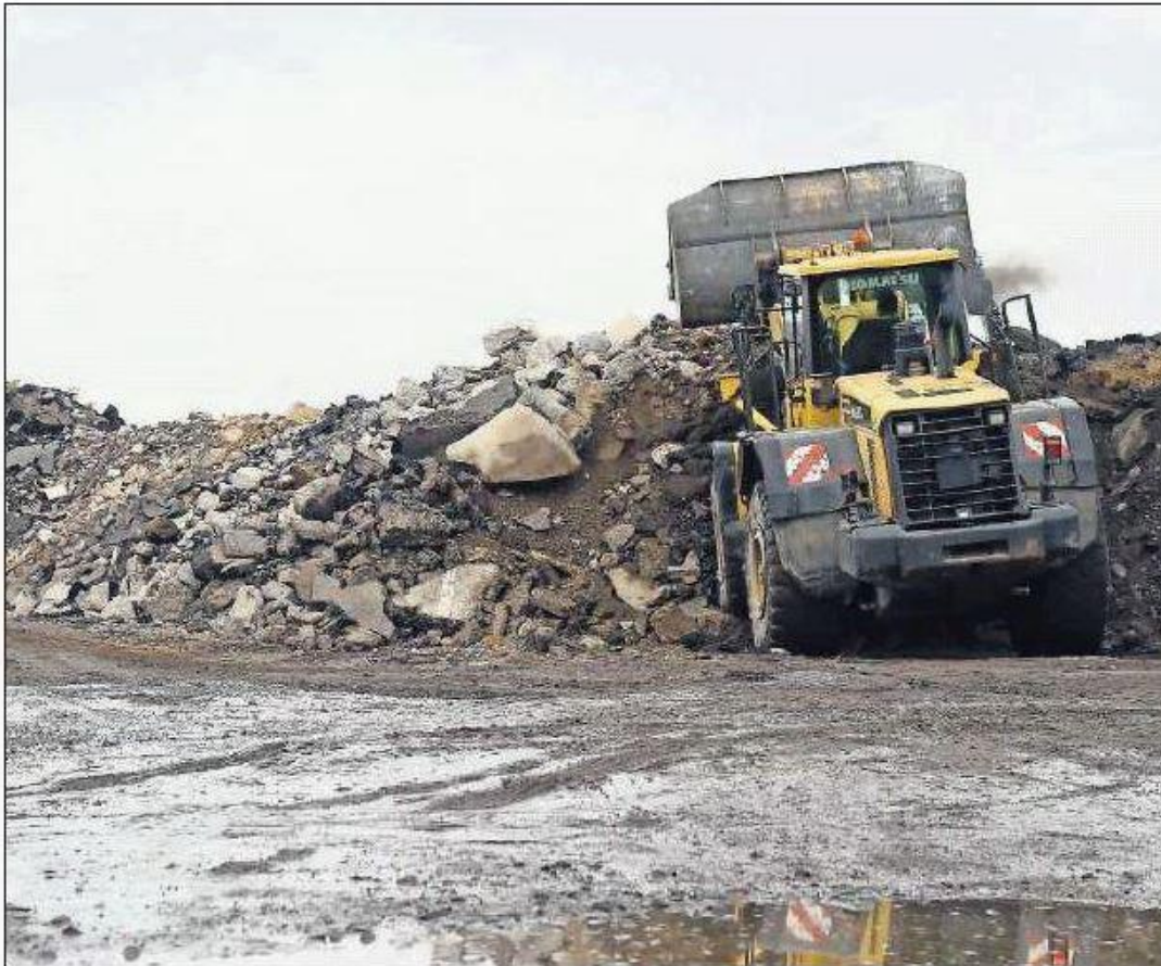
Bauschutt, der belastet und zu nichts mehr nütze ist, wird jetzt schon in Heßheim deponiert.
